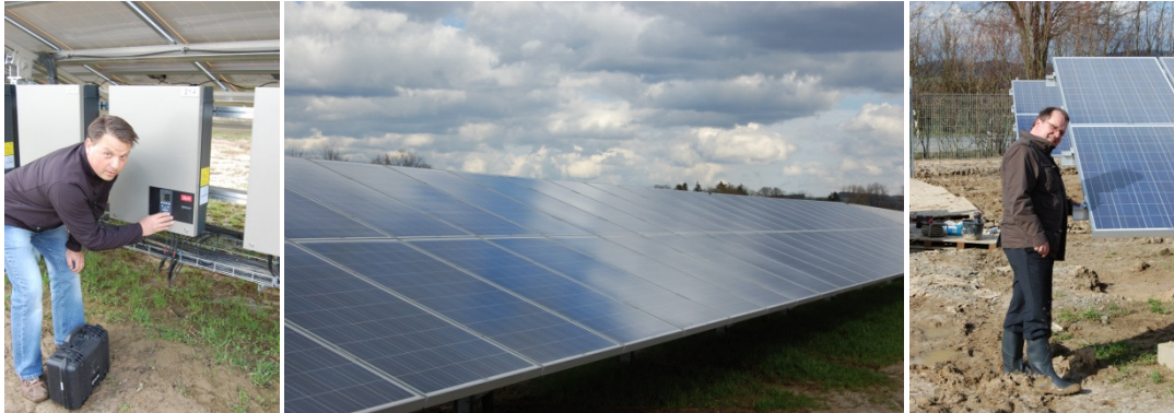
Bild: Abnahme einer 1,26 MWp Freiflächen-Photovoltaikanlage
